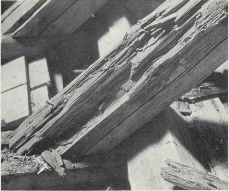
a Schäden an einem Sparrenfuß des Holzdachstuhls
